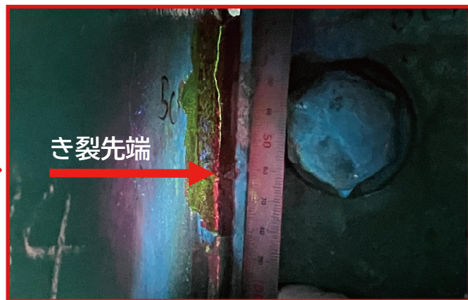
磁粉探傷により、き裂の詳細位置を検証
