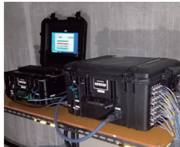
当社で開発した bridge monitoring system
