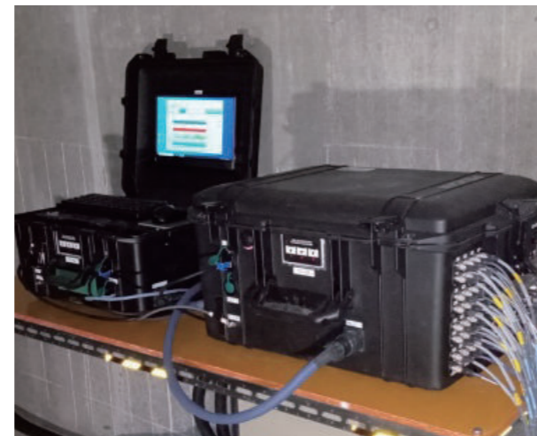
当社で開発した bridge monitoring system
