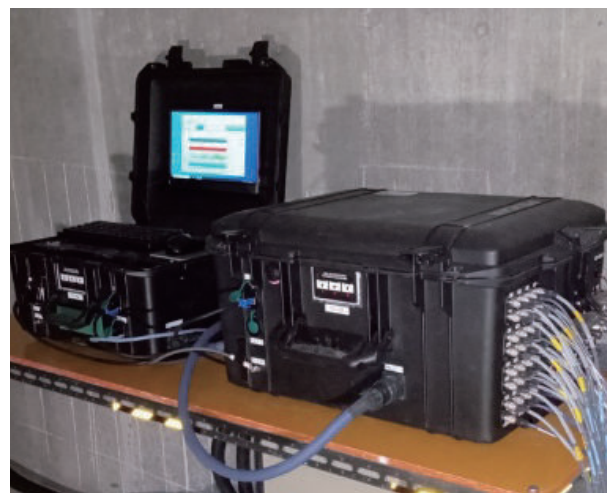
当社で開発した bridge monitoring system
