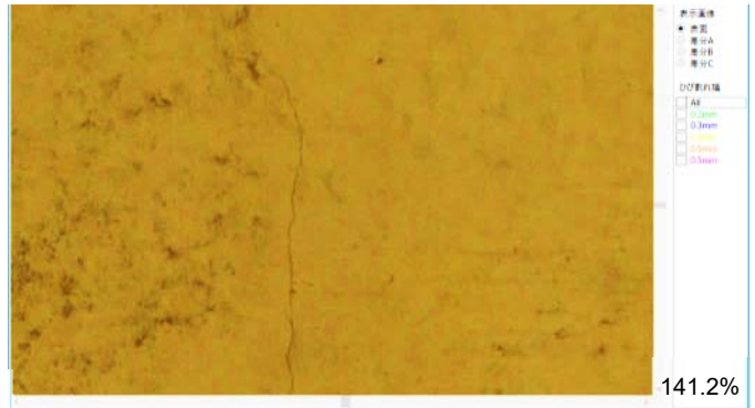
ワイド画像(ひび割れ表示あり)
